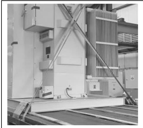
Figura 26: Tablas de madera entre la base metálica del transformador y el piso metálico del camión
