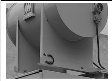
Figura 81: Unión tanque conservador con tanque principal
