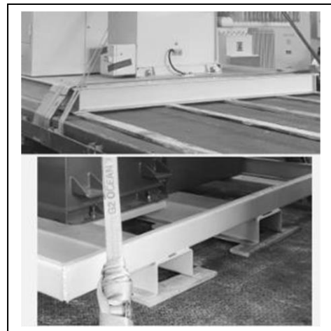
Figura 22: Tablas de madera entre la base metálica del transformador y el piso metálico del camión
