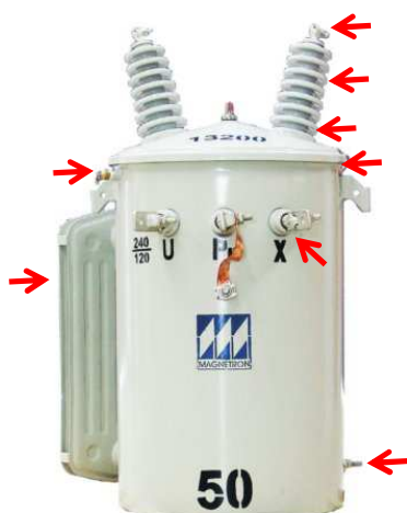
Figura 4. Puntos a inspeccionar del transformador monofásico
